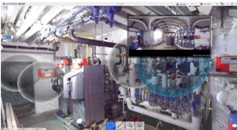
Bildunterschrift: 3D-Scanaufnahme einer Heizzentrale mit Faro-Scanner
